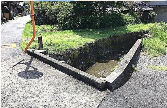
橋に手すりがなく墜落の恐れがある
